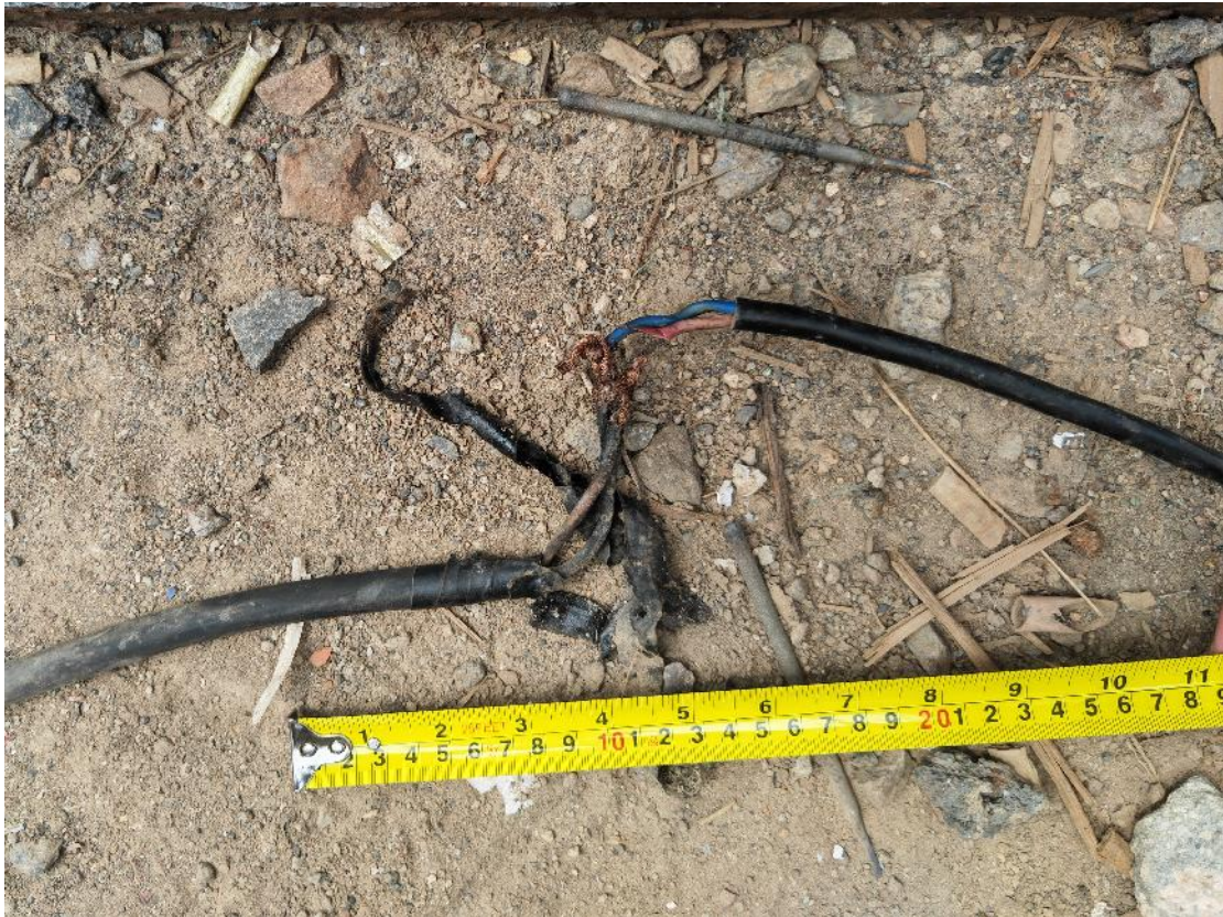
图9 电焊机电源线与临时接电用电缆线连接处
